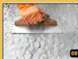
Appliquer le coulis à joint à base de sable pour bien recouvrir toutes les pierres.
